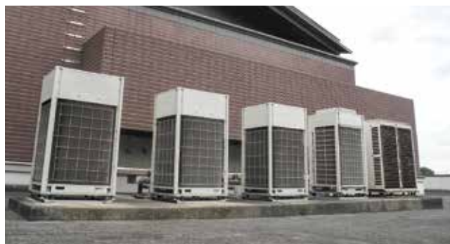
収蔵庫を支える空調機器（屋上の室外機）
