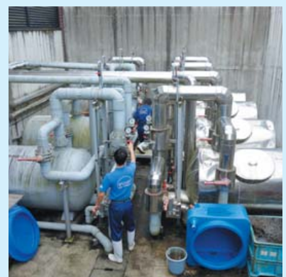
大型のろ過タンクがならぶバックヤード
